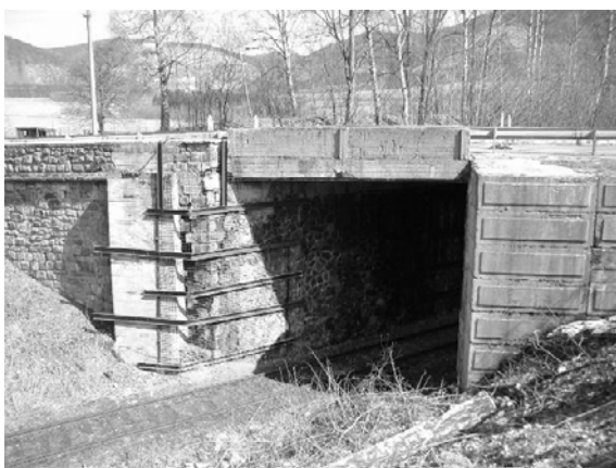
Obr.15 Havarijní stav původního mostu
