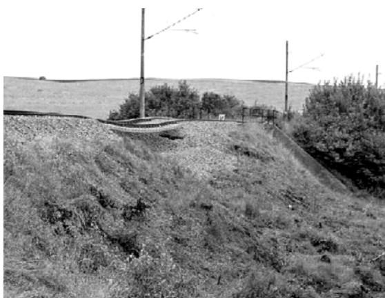
Obr.9 Pohled na deformovaný násyp
