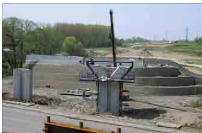
Obr. 15 Největší mostní opěry z vyztužené zeminy v České republice na dálniční estakádě D47 v Ostravě
