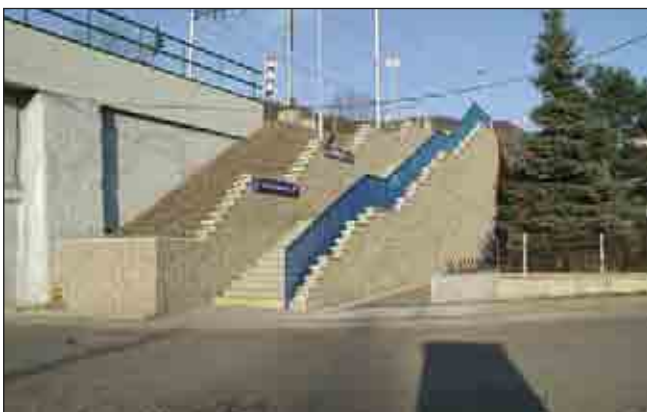
Obr. 7 Opěrné zdi přístupu na nástupiště železniční stanice Mojžíř na trati Ústí nad Labem–Děčín
