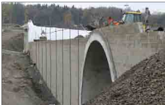
Obr. 12 Pohled na konstrukci opěrné zdi na silnici I/48 Tošanovice–Žukov – skládání betonových tvarovek
