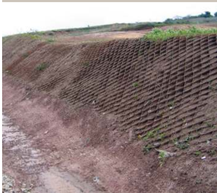
Protierozní ochrana svahu periodického vodního toku
